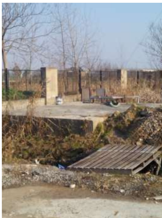
图 9.3 废水事故应急池
