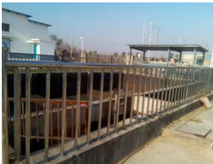
图 5.1 废水处理设施图
